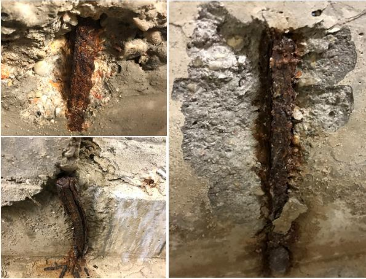
Fot. 15 Przykłady nieosłoniętych prętów zbrojeniowych, które uległy korozji
