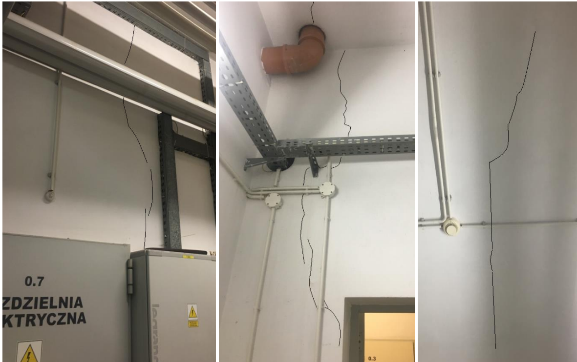
Fot. 3 Zarysowania stropu i ściany w pomieszczeniu rozdzielni elektrycznej
