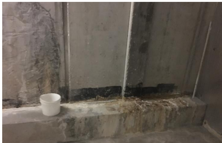
Fot. 8 Przecieki wody gruntowej/opadowej
