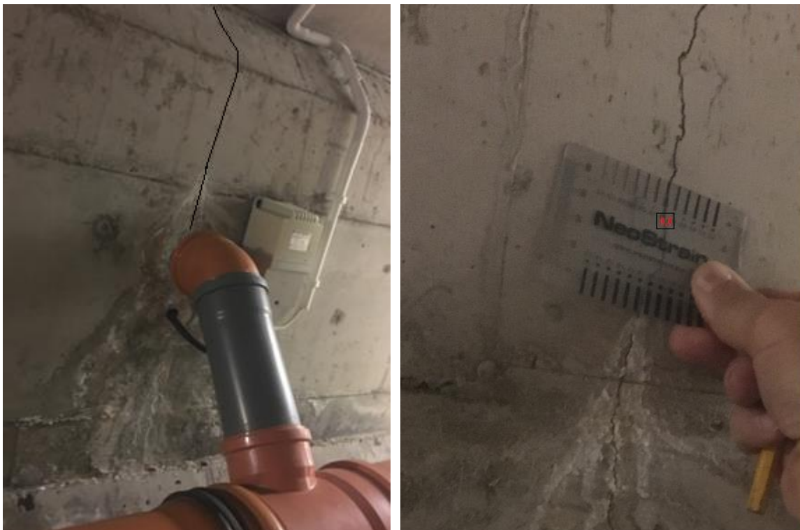
Fot. 14 Zarysowanie oraz ślady po przeciekach w miejscu przejścia rury
