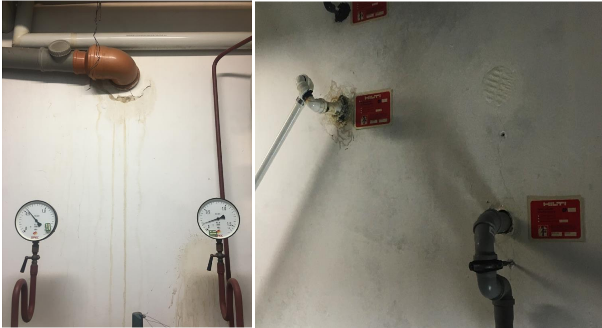
Fot. 5 Przykład przecieku na ścianie w pomieszczeniu wymiennika ciepła i przecieki na stropie w pomieszczeniu uzdatniania wody
