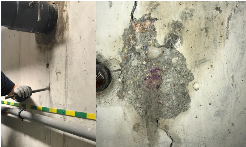
Fot. 16 Odkrywka w miejscu zarysowania- badania pH betonu
