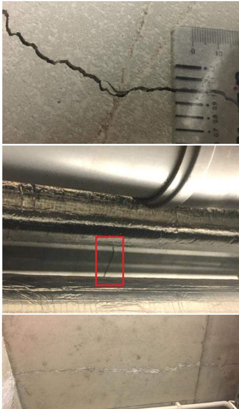
Fot. 12 Przykłady zarysowania konstrukcji żelbetowych podziemia
