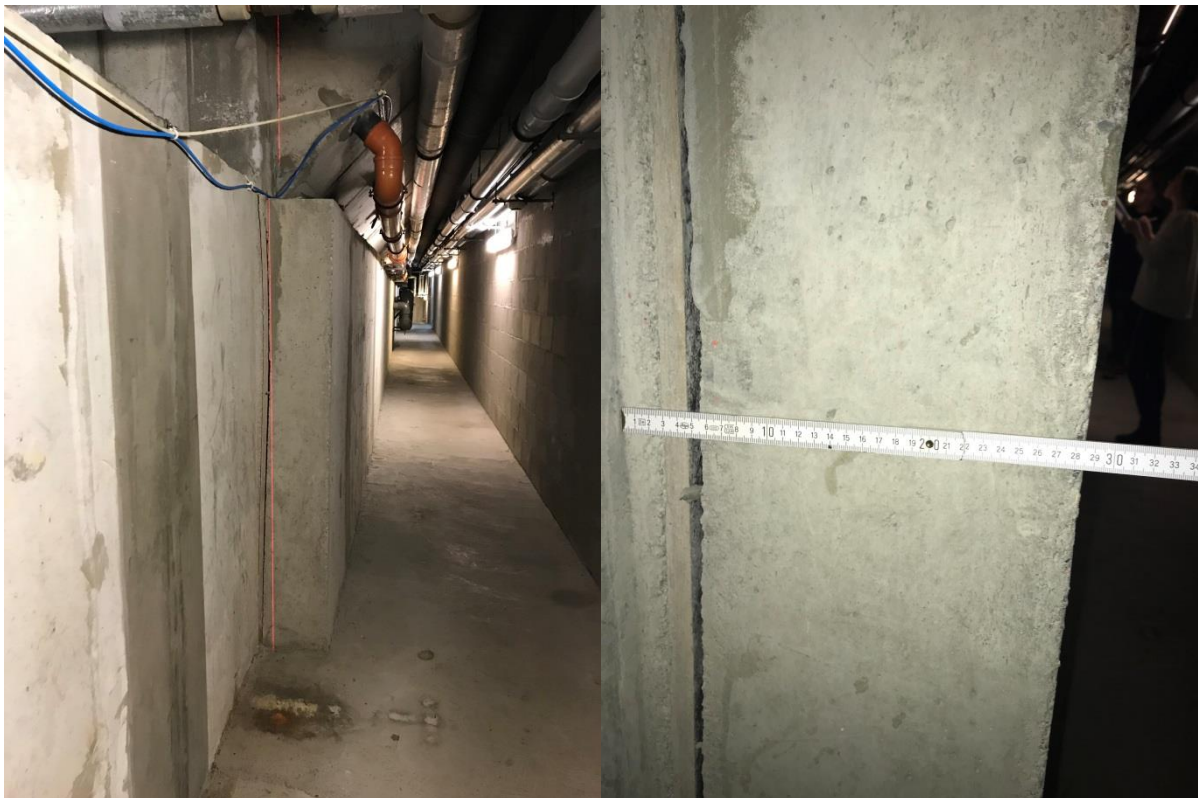
Fot. 10 Niedokładność wykonania ściany kanału
