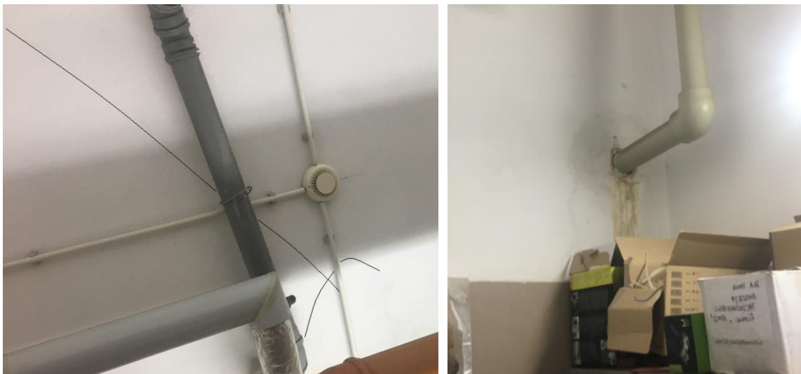
Fot. 4 Zarysowanie stropu i ślady po przecieku na ścianie w pomieszczeniu magazynowym
