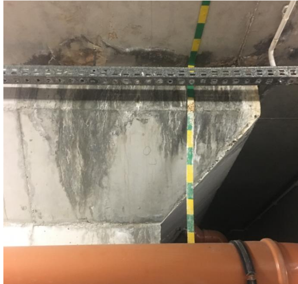
Fot. 13 Ślady po przecieku wody basenowej
