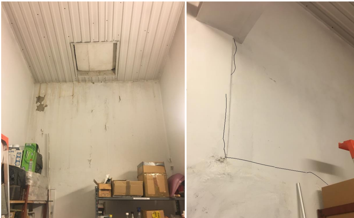
Fot. 6 Przeciek i zarysowania ściany zewnętrznej w pobliżu wejścia do podziemia technologicznego
